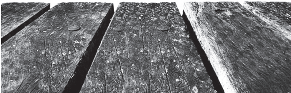
Φωτογραφία 163: Είναι σύνηθες φαινόμενο η αποσάθρωση να συνυπάρχει με διαφόρων ειδών βιολογικές προσβολές, στις ξύλινες κατασκευές που εκτίθενται στο εξωτερικό περιβάλλον. Φωτογραφία του συγγραφέα.
